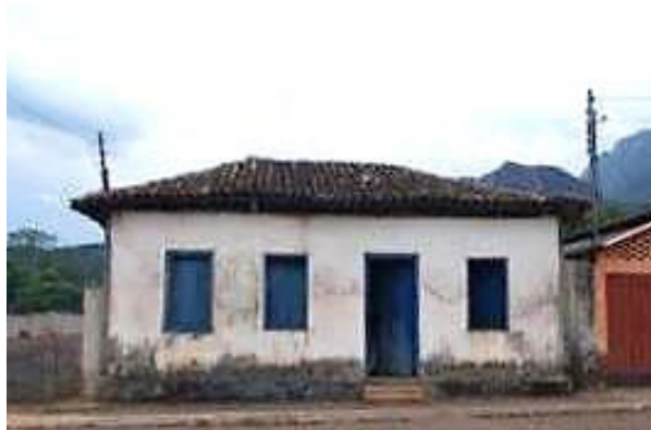
Moradia em precário estado de conservação
